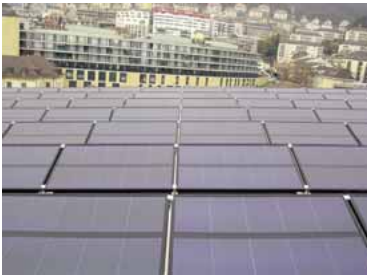
Viteos SA réalise des installations solaires photovoltaïques de technologie «silicium amorphe», comme ici sur le stade de la Maladière avec un champ de cellule d'une surface de 750 m 2 . • Photo: archives
