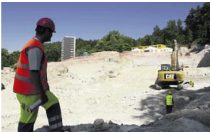
Bonne nouvelle pour les habitants du quartier des Cadolles: les travaux de terrassement - et les nuisances qui les accompagnent - prendront fin en juillet.
