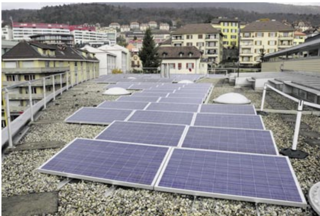
Deux technologies de panneaux photovoltaïques sont comparées par Viteos sur le toit du CPLN. • Photo: Viteos
