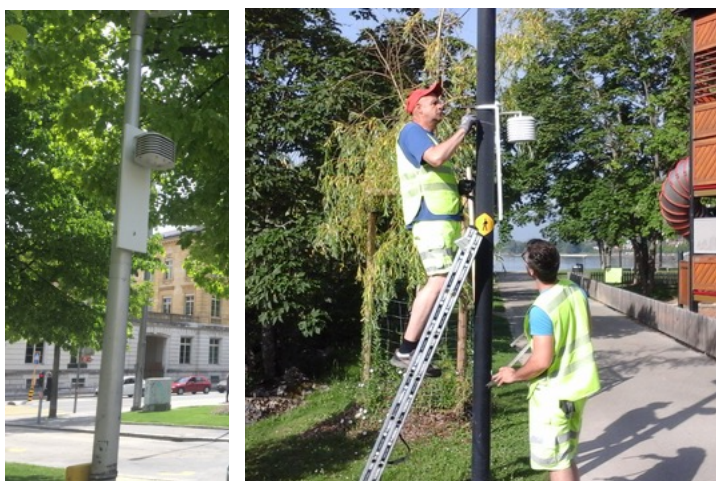
Figure 1 : Exemples de stations de mesure de la température installées en ville de Neuchâtel.
