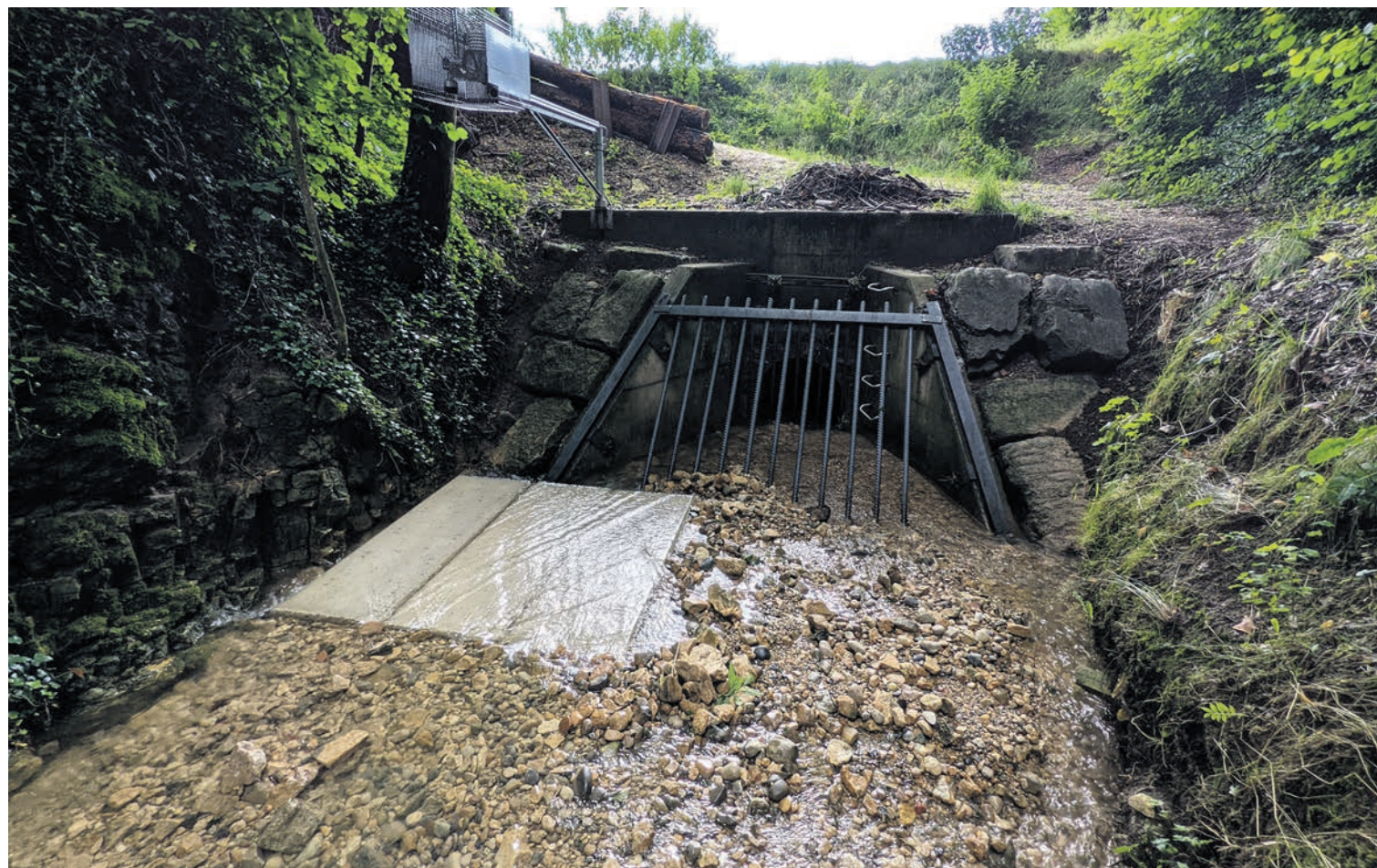
Fin juillet, les alluvions charriées par les eaux gonflées du ruz Chatru commençait à obstruer l'entrée de la canalisation. SERVICE DES INFRASTRUCTURES
