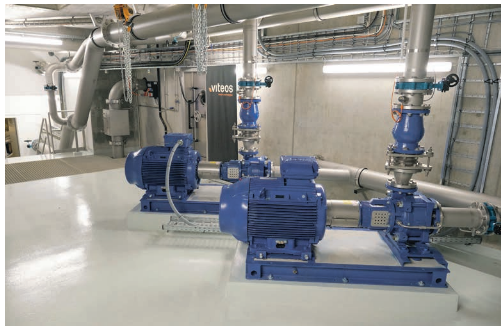
Entièrement rénové, le réservoir d'eau potable de Fontaine-André dispose d'infrastructures flambant neuves. BERNARD PYTHON
