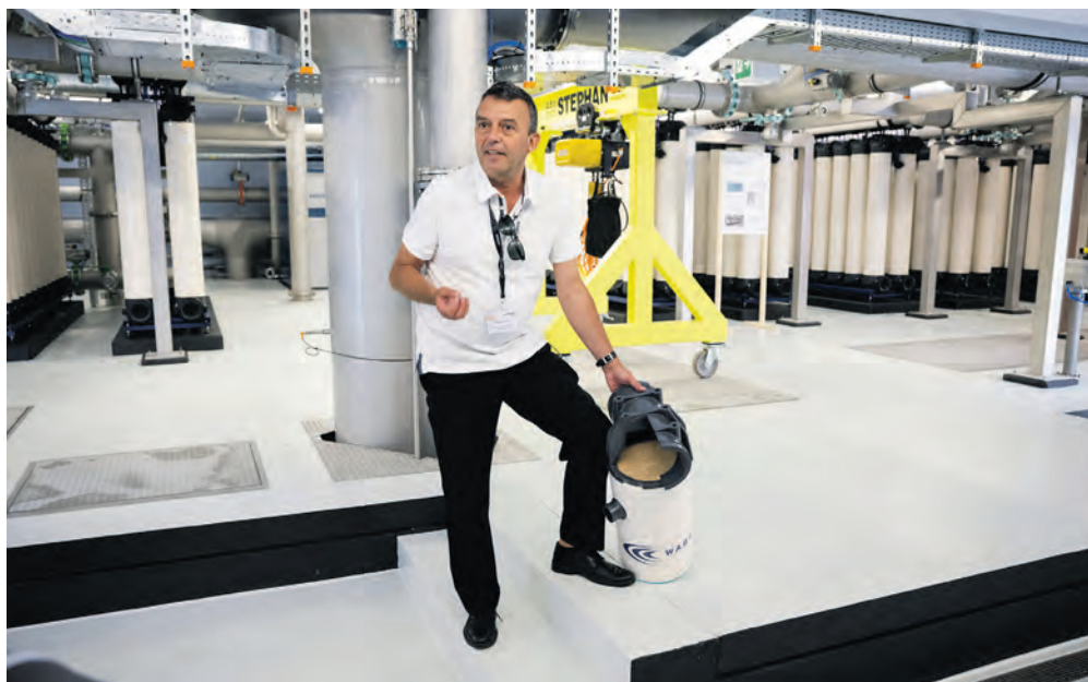
Cheville ouvrière du projet, l'ingénieur de Viteos Thierry Broglie a fait visiter les nouvelles infrastructures, dévoilant les mécanismes de filtration très fine de la station. PHOTOS LUCAS VUITEL
