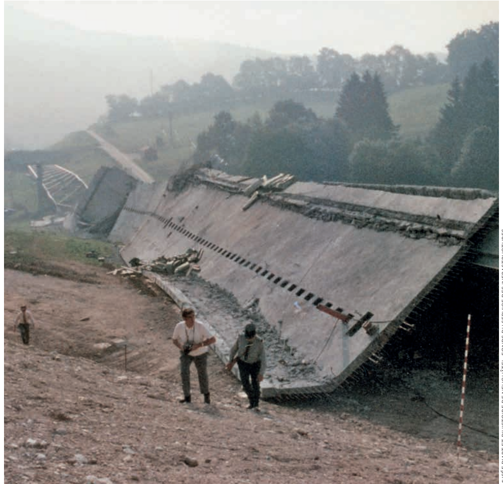
Jeudi 13 septembre 1973, à 9h16, le pont s'effondre, précipitant 250 tonnes de béton dans le vide.
