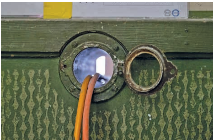
A quoi sert cet orifice? A l'époque, il permettait au concierge de mesurer la température des classes à l'aide d'un thermomètre.
