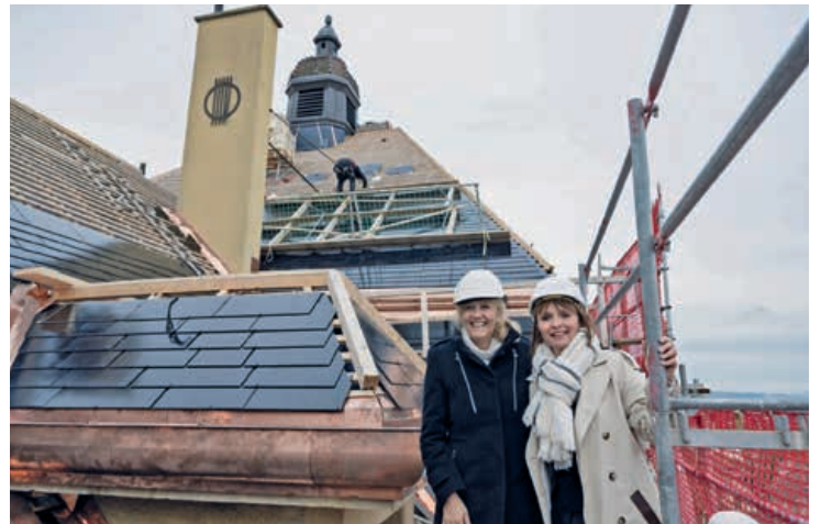
Nicole Baur et Violaine Blétry-de Montmollin sur le toit du collège des Parcs, où sont posées des tuiles solaires.
