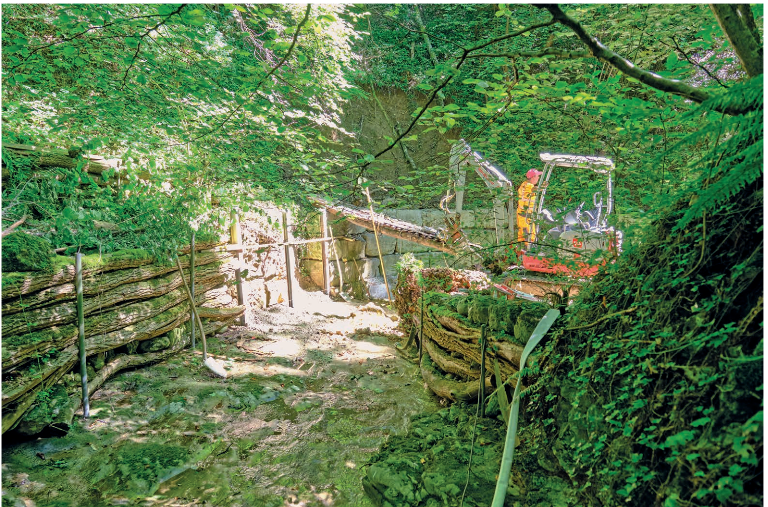
Le Ruz Chatru, qui s'écoule à l'est de Corcelles, draine les eaux depuis le secteur des Vernets en direction du lac, via Milvignes. Un projet de rivière à coordonner avec Milvignes doit permettre d'établir des mesures de la source au lac. BERNARD PYTHON
