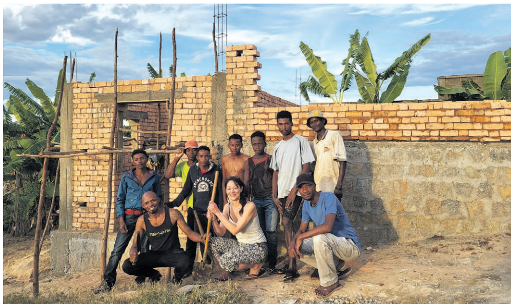
Lucrezia Hausmann et les ouvriers malgaches, devant la maison en construction. PHOTOS SP
