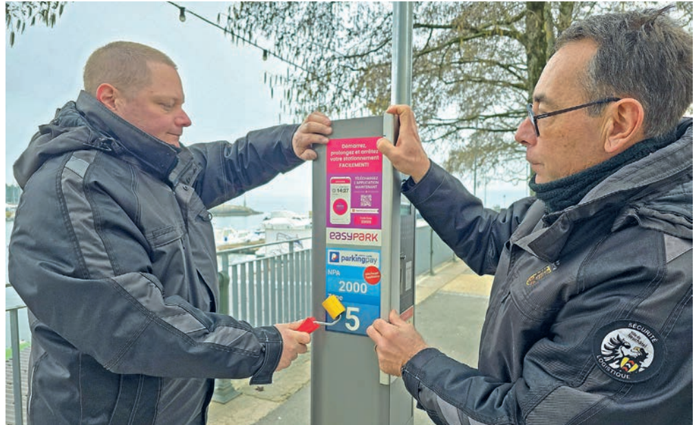
Vincent Maurer et Pascal Maeder, de l'Office de la logistique et des ports, installent les informations de paiement sur un horodateur près du port.
