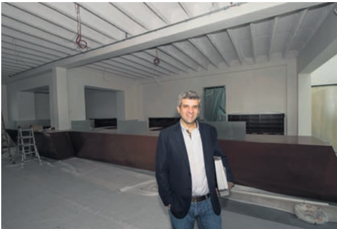
Le chef du Service communal de la population, Bertrand Cottier, dans la nouvelle zone d'accueil qui ouvrira ses portes le jeudi 1 er octobre.
