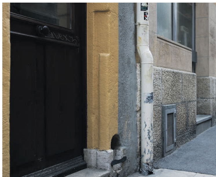
Des encoches pour protéger les maisons des crues du Seyon. • Photo: Stefano Iori
