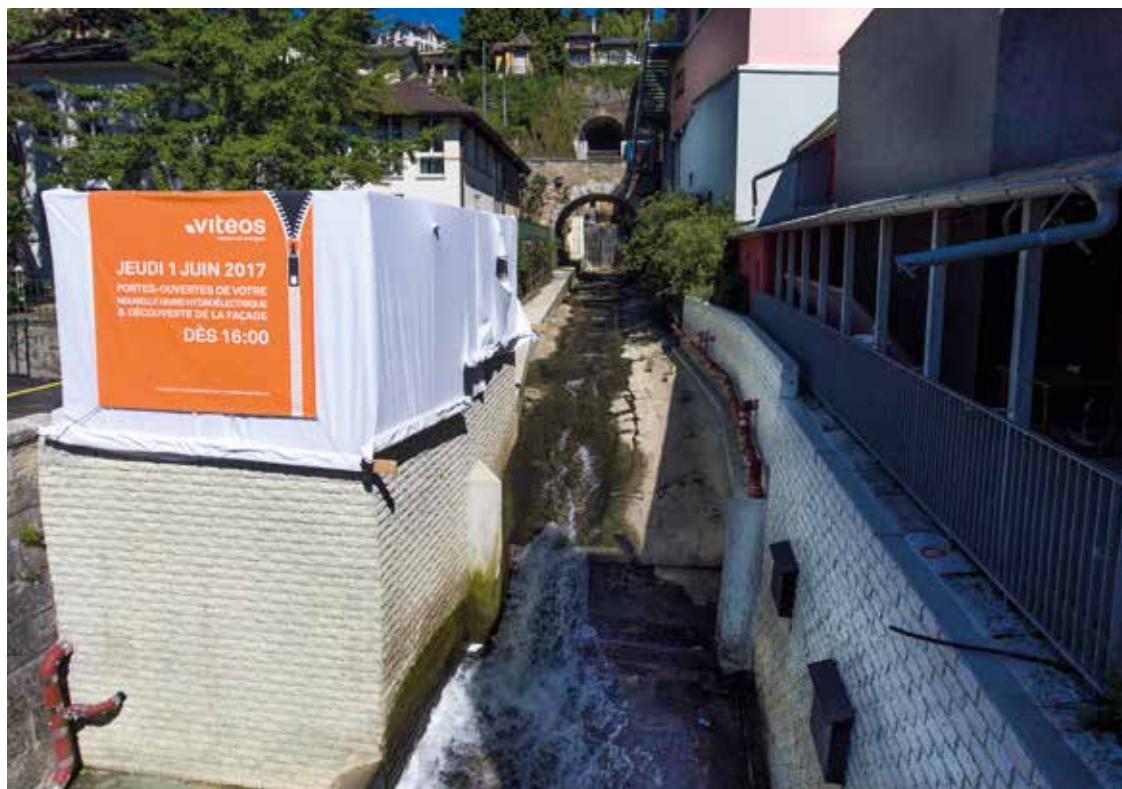
En service depuis décembre, la nouvelle centrale hydroélectrique du Seyon produit l'équivalent de la consommation annuelle de 160 ménages. • Photo: Stefano Iori
