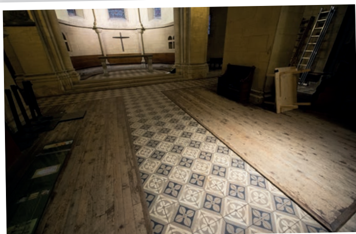
L'assainissement du sol s'avère indispensable. Hormis la grille de l'allée centrale qui sera conservée, le plancher et le carrelage seront remplacés par un sol minéral. • Photo: Stefano Iori
