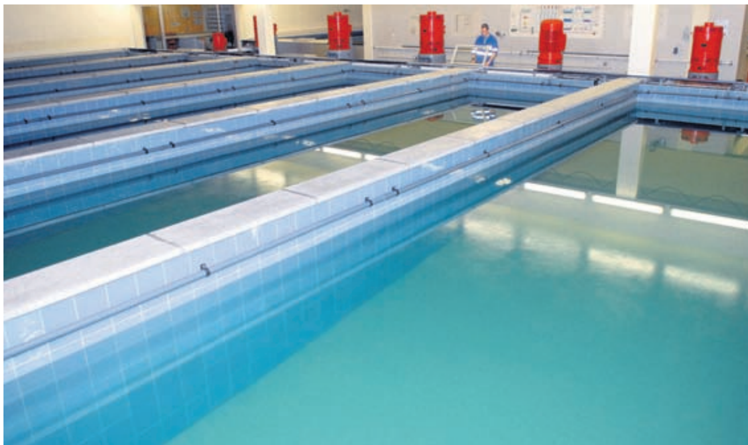
La consommation d'un ménage neuchâtelois s'élève à environ 144 m 3 d'eau par an (ci-dessus Station de pompage et de conditionnement de Champ-Bougin).
