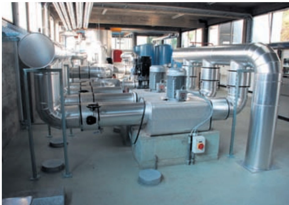
La centrale de chauffage de la Maladière a été entièrement rénovée dans le cadre des travaux menés sur le réseau de chauffage à distance. • Photo: sp
