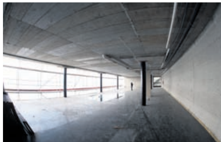
Deux nouvelles salles de classes seront créées dans le cadre des travaux de rénovation du collège du Crêt-du-Chêne.
