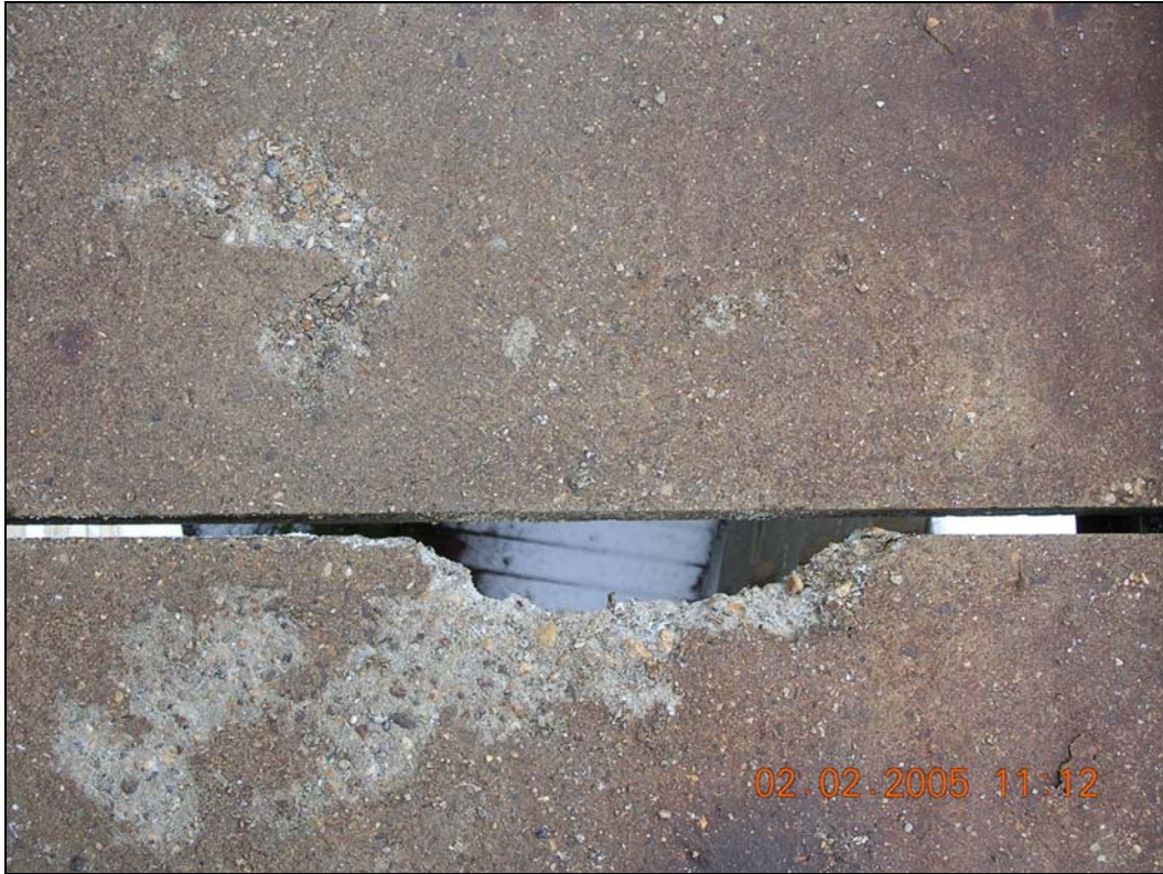
Etat des dalles
