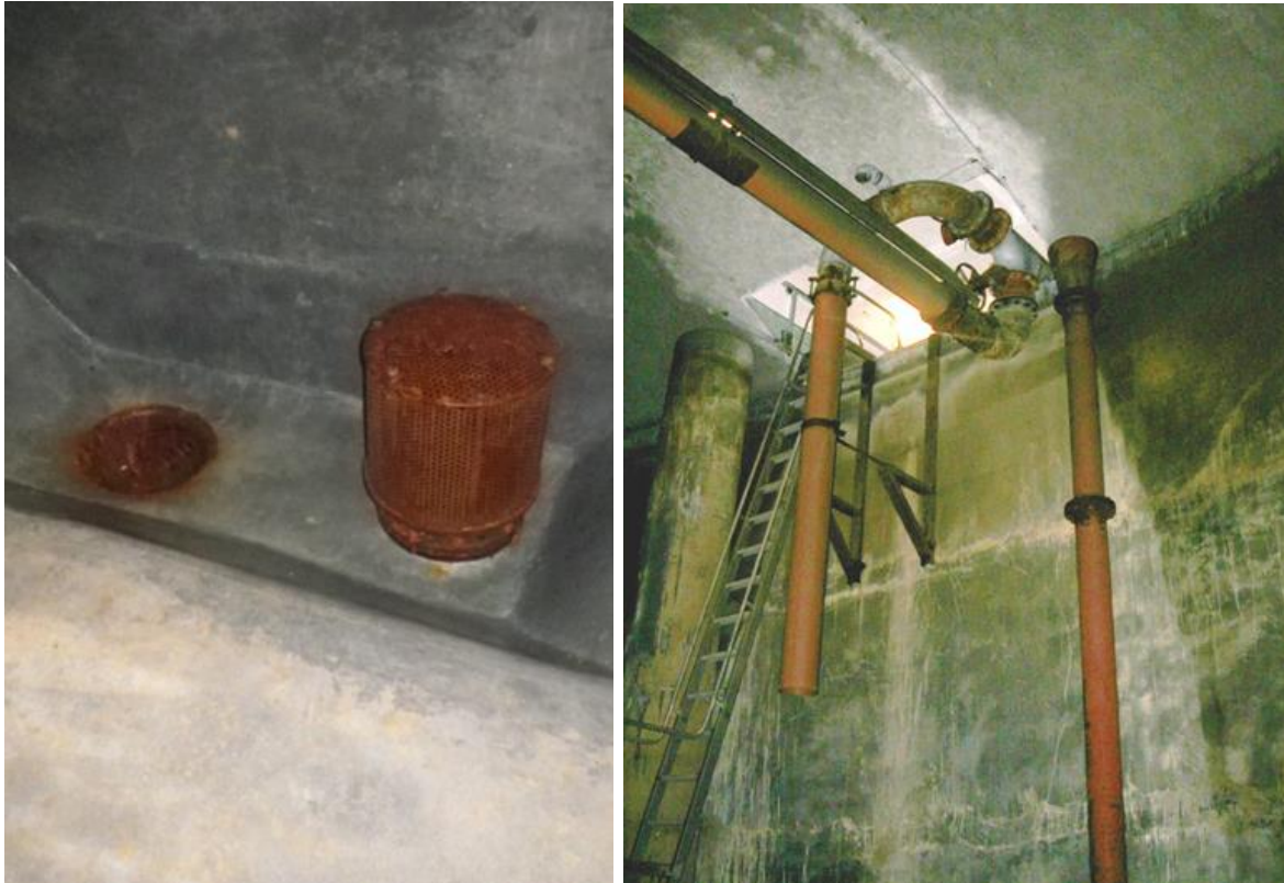
Crépine et conduites de la cuve intérieure attaquées par la rouille
