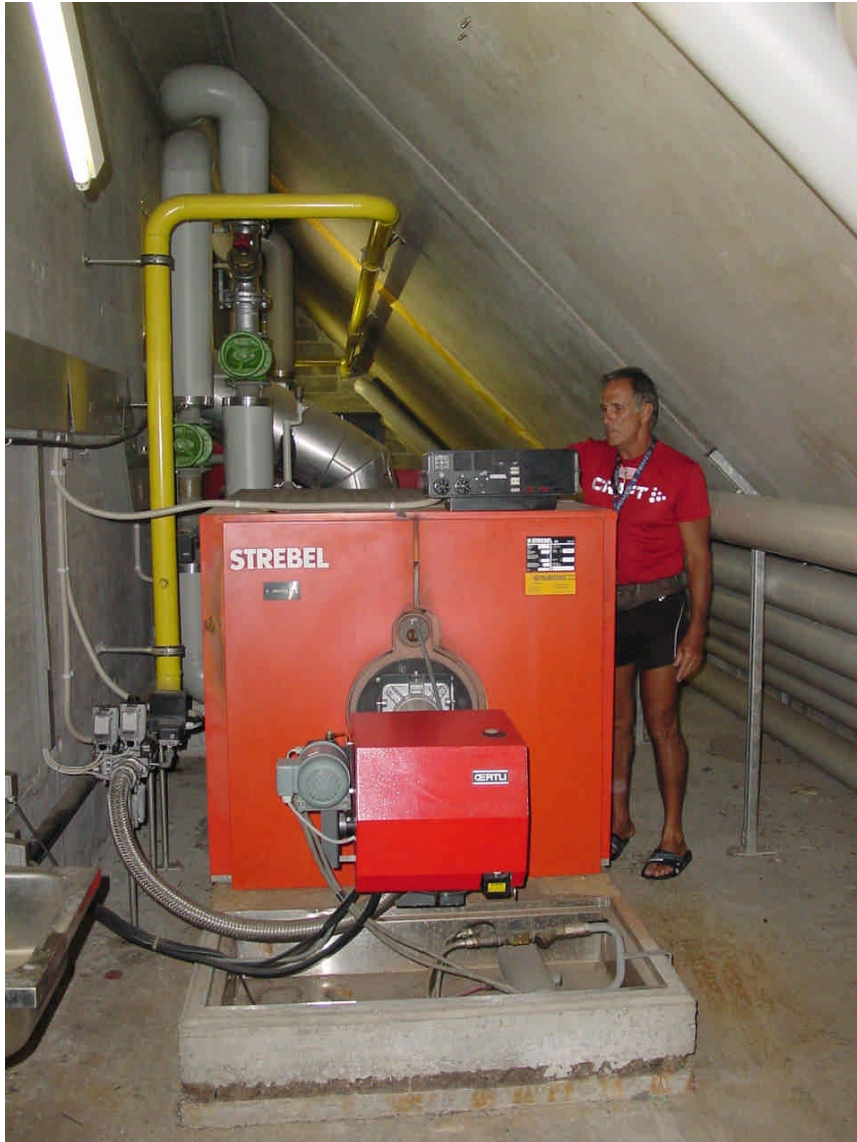
Figure 1 : local dans le faîte du toit contenant les deux chaudières
