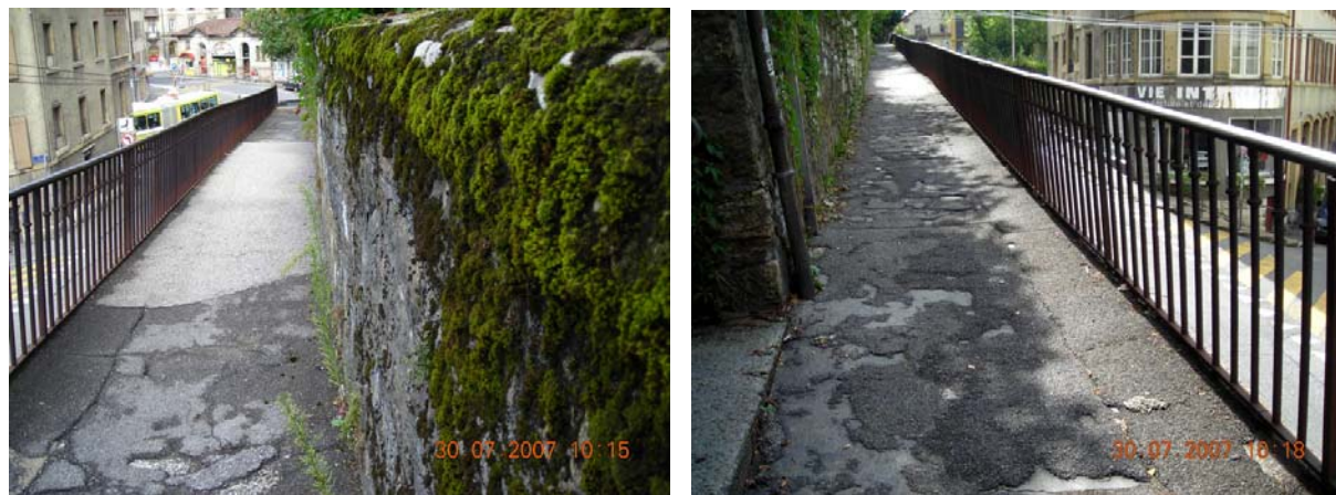
Gonflement du mur supérieur et cheminement piéton
