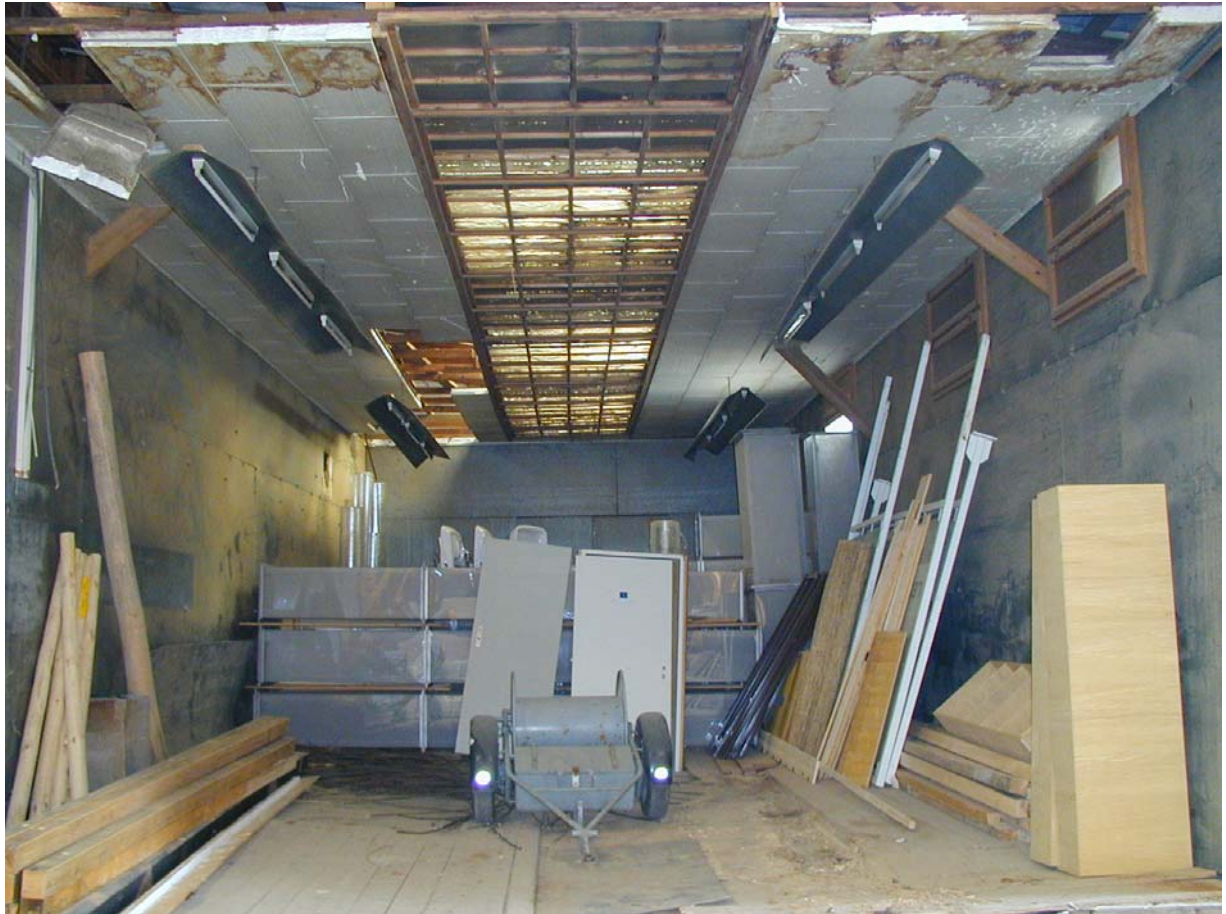
Figure 5 : locaux Zimmermann, fortement dégradés
