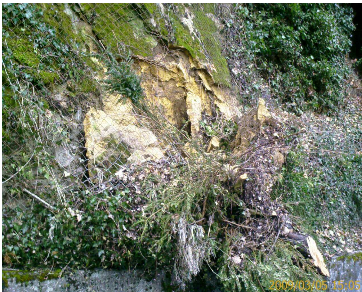
Eboulement et déchirure du treillis ancien au chemin de la Papeterie
