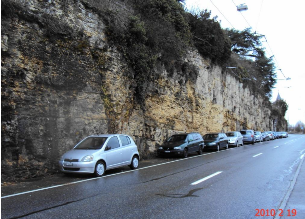
Rue des Saars, travaux de purges et renforcement local de la falaise de manière préventive
