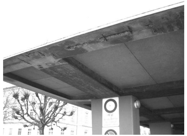
Dégâts au béton
