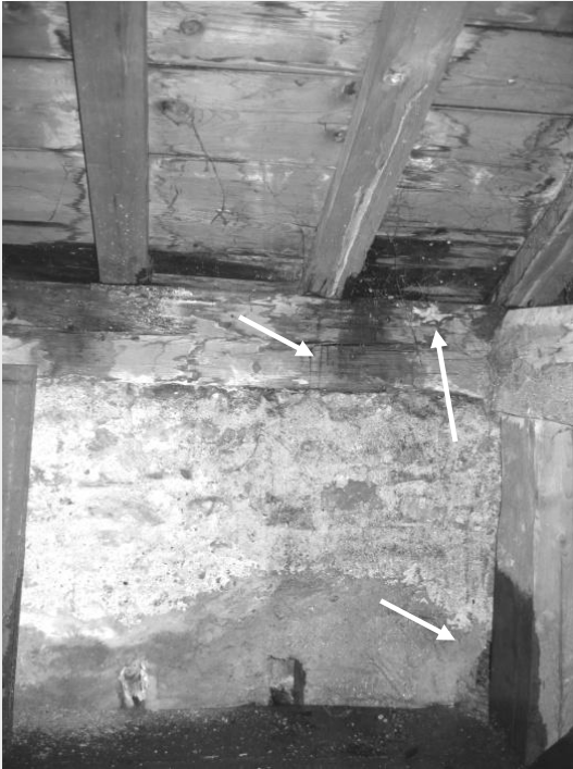
Figure 5. Etat de la charpente lors des inondations (décembre 2010).
