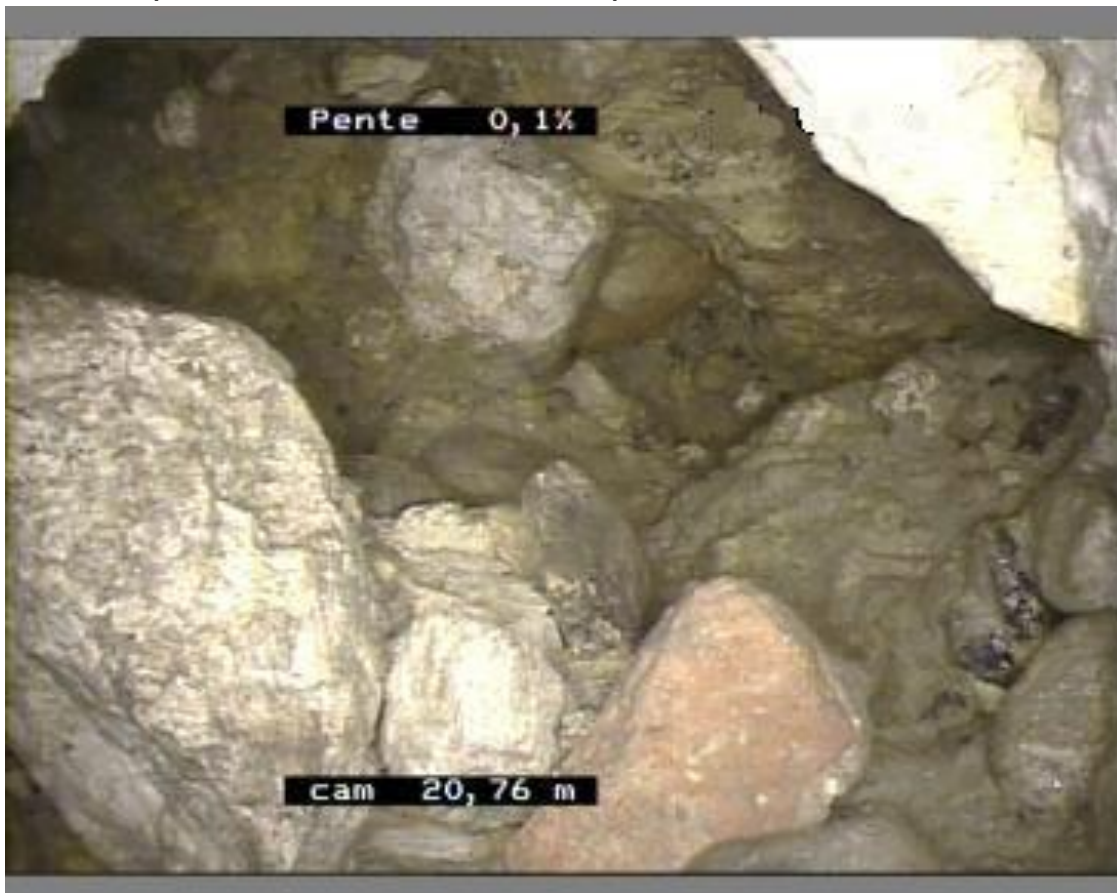
Obstruction de la canalisation suite à l'éclatement de la paroi
