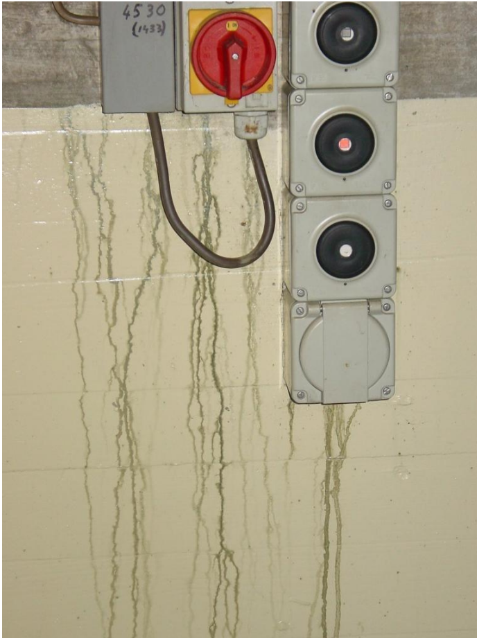
Traces de coulures dues à la condensation
