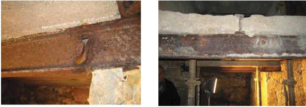
Figure 13. Etat de conservation des poutrelles
