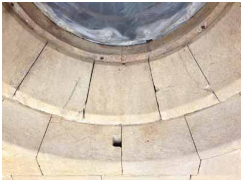
Figure 6. Ouverture des joints sur la Rose, avant remplacement
