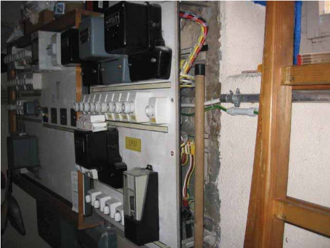
Figure 21. Le tableau électrique
