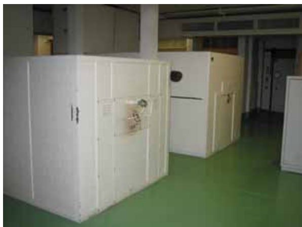
Fig.3 : Salle des fours
