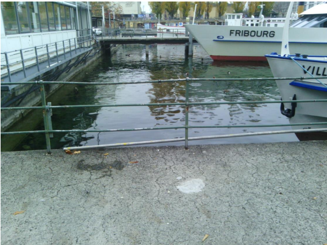
Garde corps hors norme
