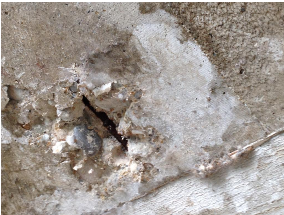
Sous-dalle débarcadère n° 2, armature apparente
