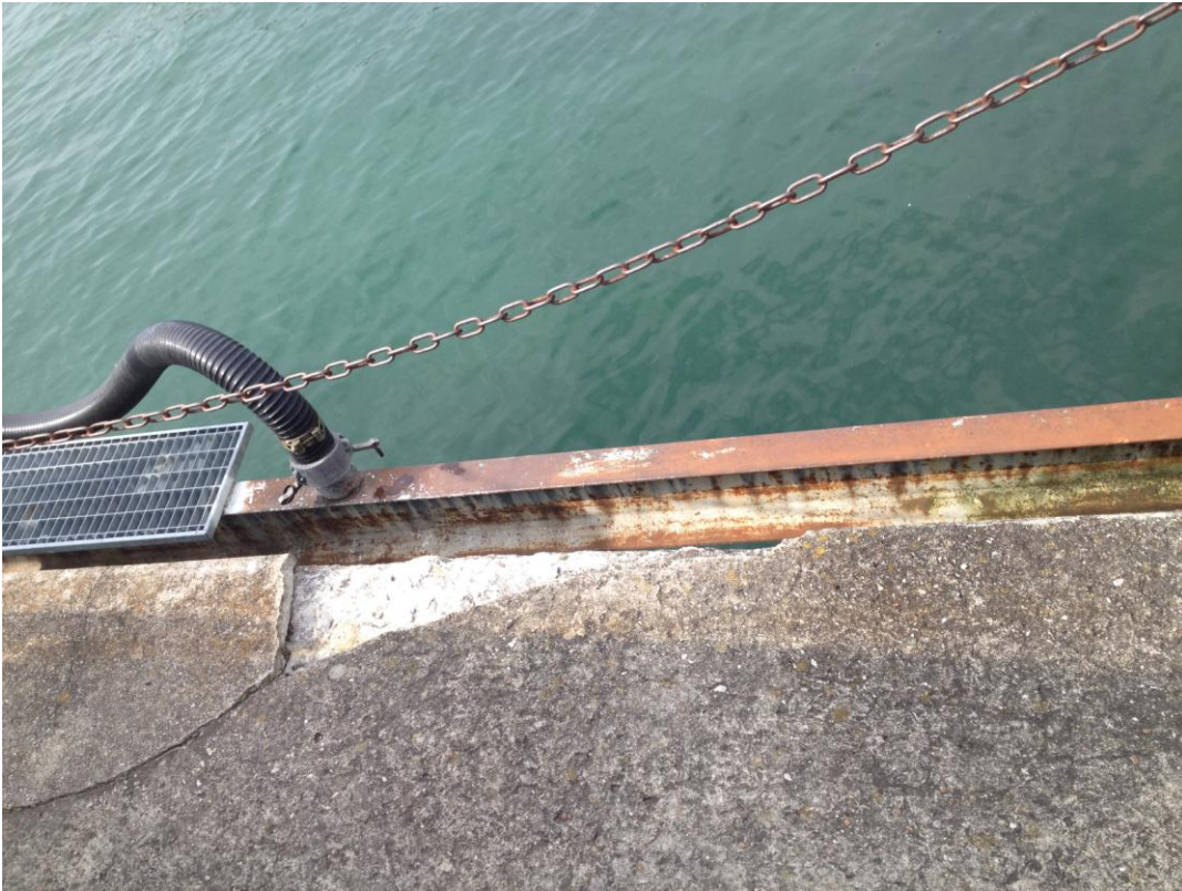
Bord de dalle décollée du débarcadère n° 3
